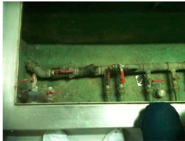
Abb. 3: Aufnahme Produktionsgebäude „Verteilung“ vom Pumpenhaus (Brunnen) mit unterschiedlichen Abgängen und Rückflußverhinderer , „Produktionswasser“ ( Aufnahme Exner )
